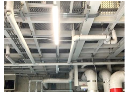
熱供給プラント (神奈川県横浜市)
