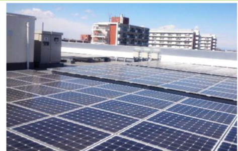
太陽光発電設備（光が丘IMA中央館）
