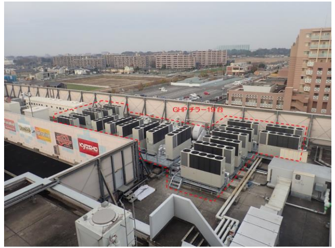
更新後熱源機器
